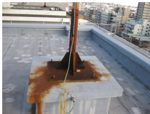
LPS部材の腐食
