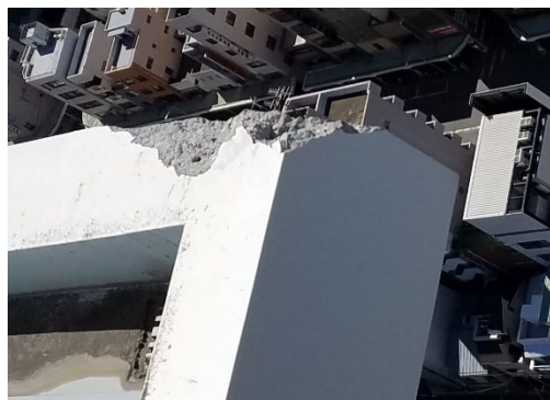
建物への落雷・破損
