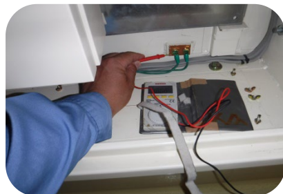
接地状況の確認
