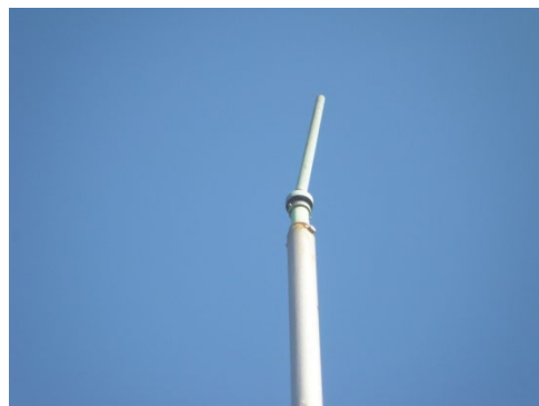
突針の劣化・変形
